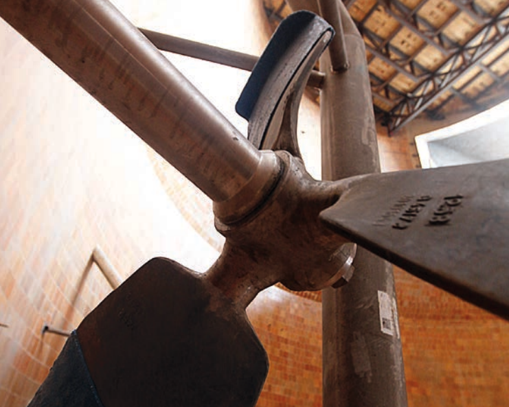
Una vista interior de las hélices del ventilador de absorción por agitado, o depuradores conforme se instalan en la planta. Fotografías/Alissa Hollimon
